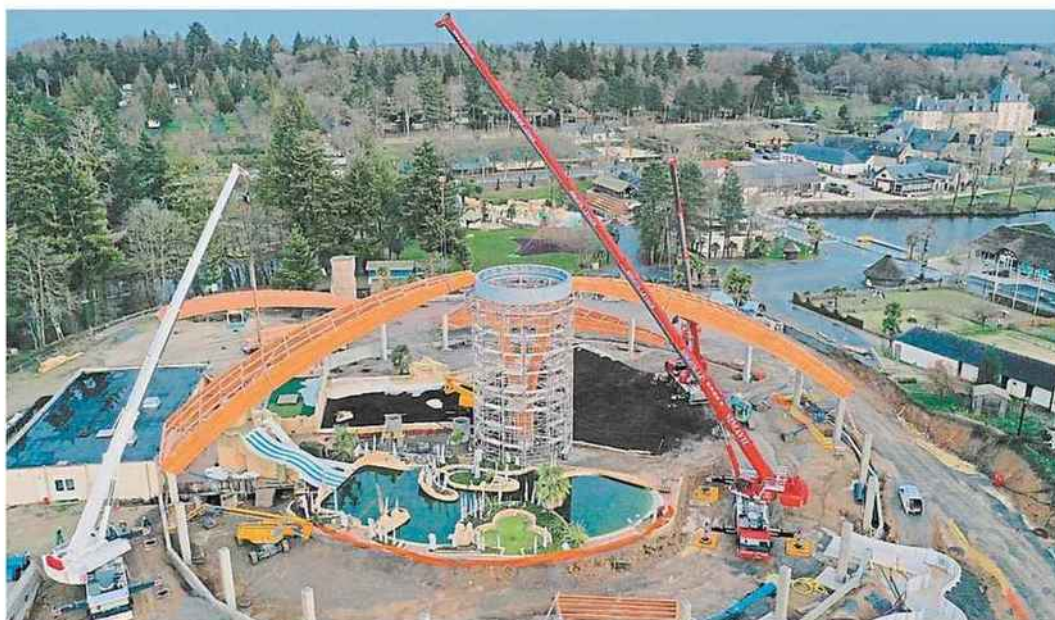
Des entreprises de la région travaillent à l'édification du Dôme qui a été étudié pour s'intégrer parfaitement à l'environnement du Domaine des Ormes.
